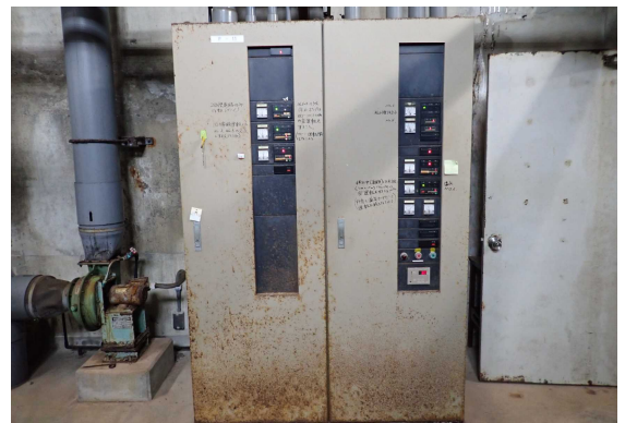
図 1. 今回停止した配電盤。設置箇所：トンネル水槽横。
